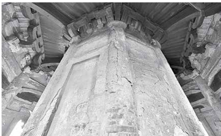
图6 瑞光塔三层塔心柱东北角 (照片引自苏州市文物保护管理所瑞光塔全景摄影成果)
